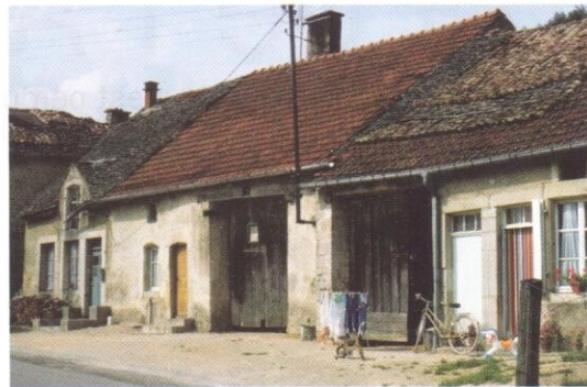
À droite, une remarquable association entre la lave calcaire, la tuile canal et la tuile mécanique. Pour la tuile canal, la pente est trop forte (Midrevaux).
