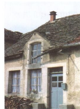
Il est exceptionnel, en Lorraine, qu'une toiture porte une lucarne. La toiture de celle-ci se fonde admirablement bien dans celle de la maison (Midrevaux).
